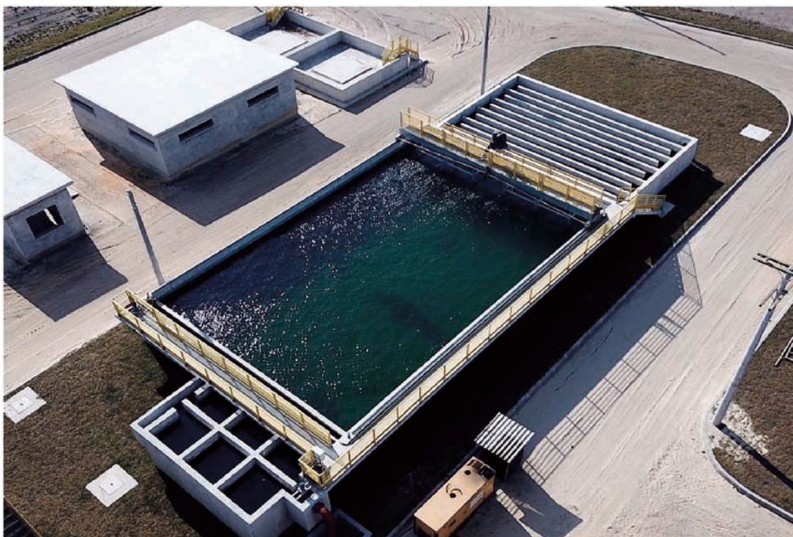
Decantador Secundário com raspador de lodo longitudinal
